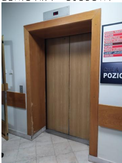
Widok na parterze dźwigu nr 1 osobowego
