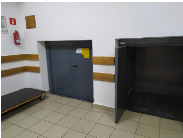
Widok dźwigów na parterze
