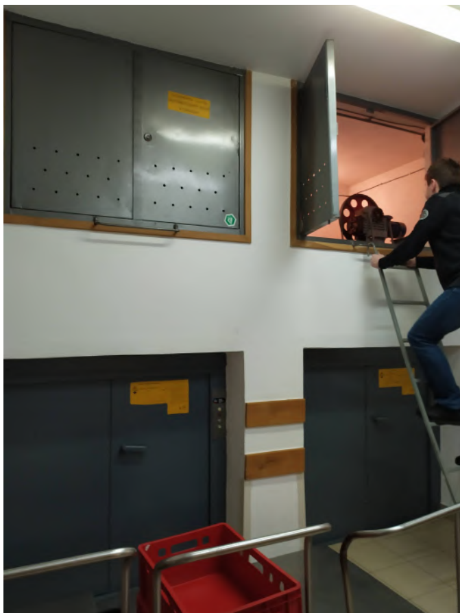
Widok dźwigów na piętrze
