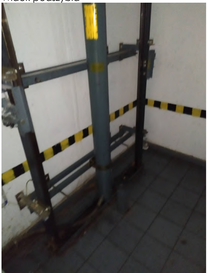
Widok podszybia z widocznymi zaciekami po zawilgoceniu ścian
