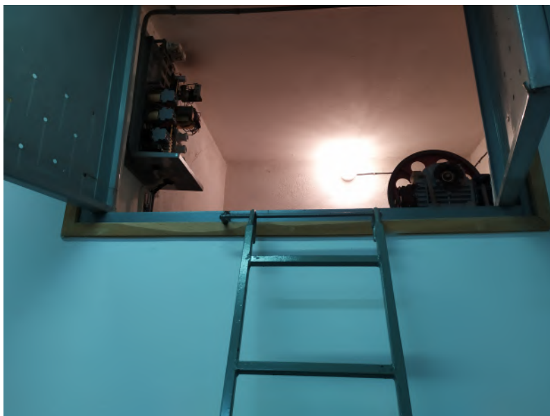
Widok maszynowni na piętrze
